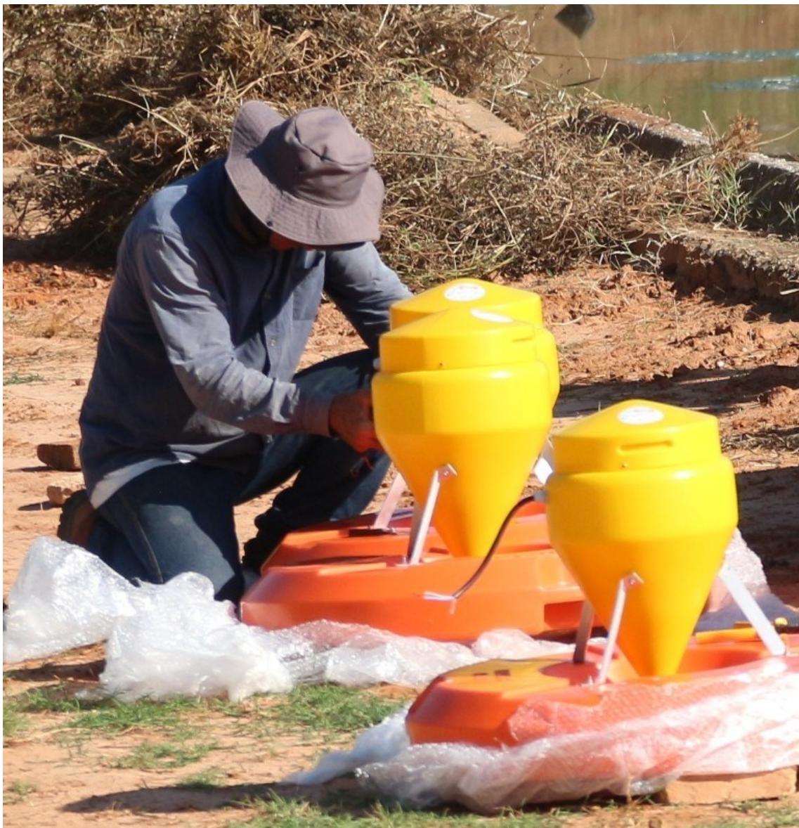
Implantação de seis aeradores na Lagoa de Tratamento do Bairro Mirassol, visando o melhor resultado do serviço de tratamento de esgoto
