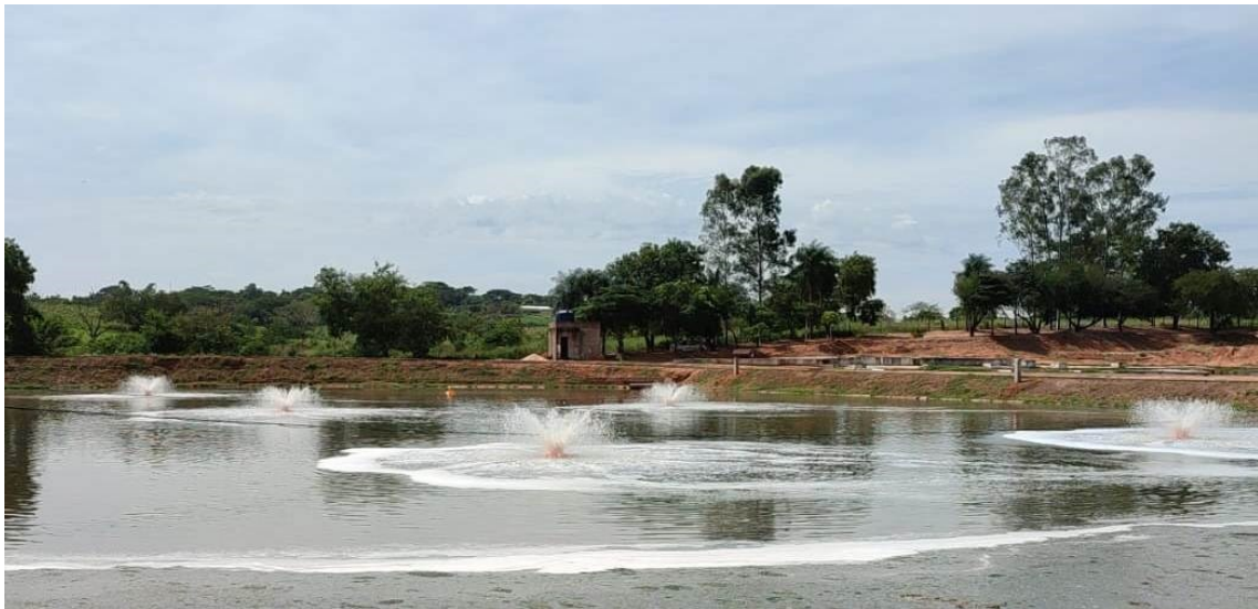
Implantação de seis aeradores na Lagoa de Tratamento do Bairro Mirassol, visando o melhor resultado do serviço de tratamento de esgoto
