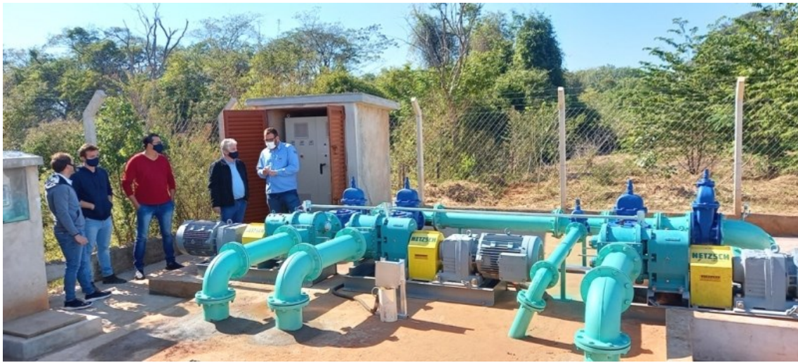
Estação Elevatória de Esgoto do Residencial São Paulo
