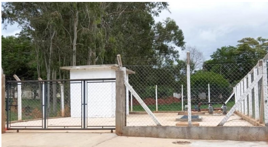
Estação Elevatória de Esgoto do Jardim das Palmeiras
